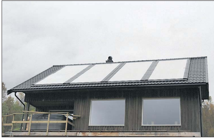
SOLFANGERE: På taket er det 4x12 kvadratmeter med solfangere som hver bidrar med 24.000 kWh årlig. Huset produserer mye mer energi enn det forbruker, men må ha noe strøm når sola er borte midt-vinters.
